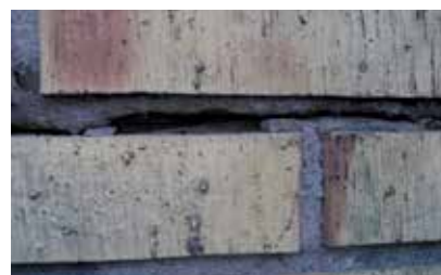
Korroderande armering spränger och trycker ut murverksfogen.
