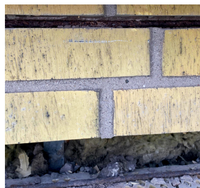
Korroderande armering spränger och trycker ut murverksfogen.
