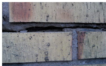
Korroderande armering spränger och trycker ut murverksfogen.
